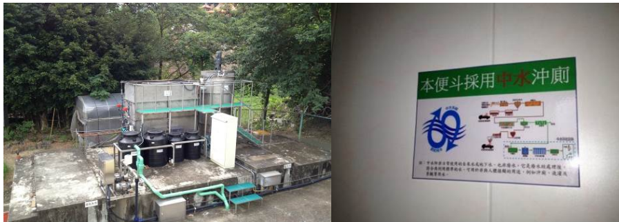
中水回收設施處理及設施實景
